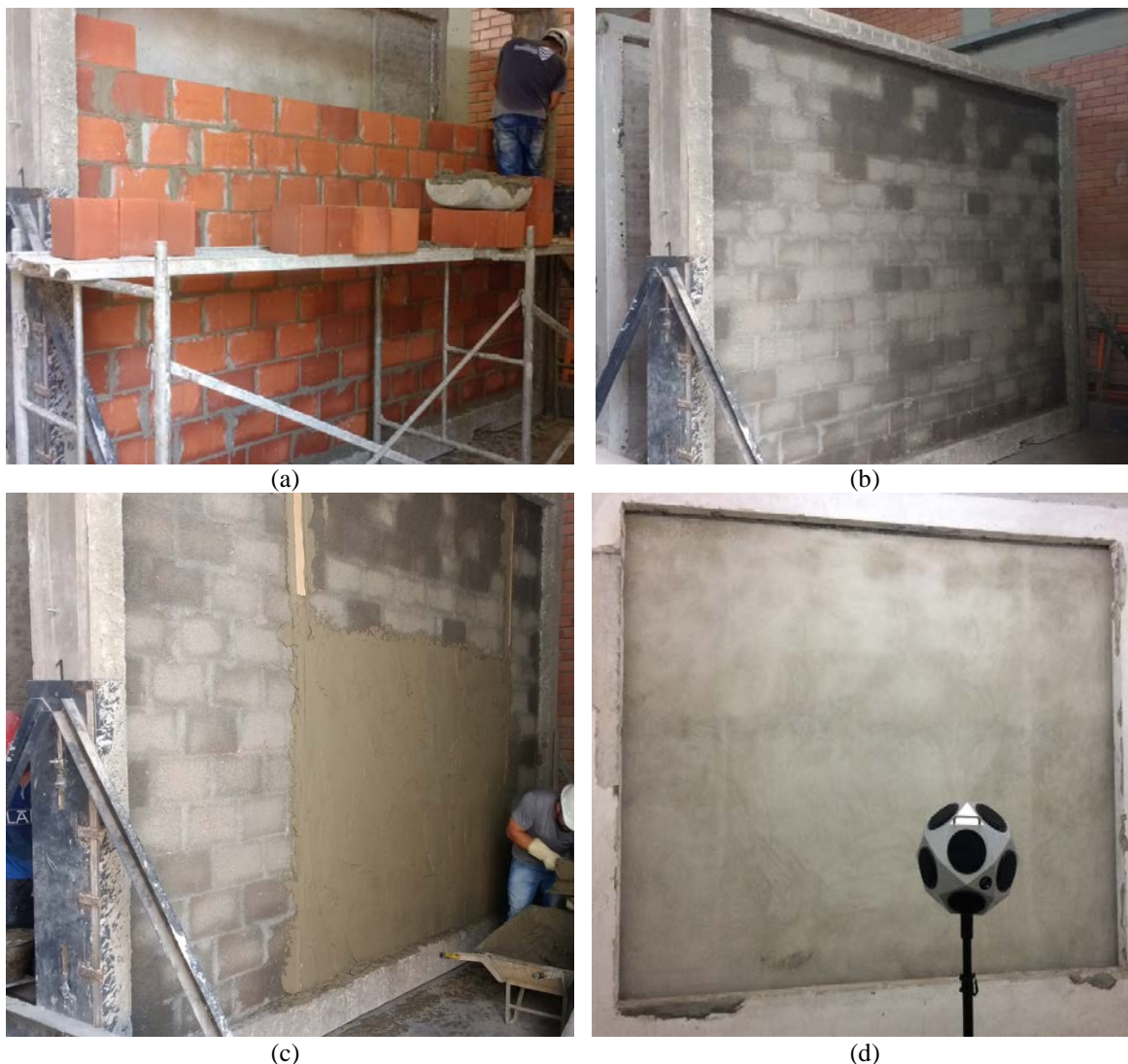
Figura 1 - Etapas de execução de amostra de alvenaria estrutural: (a) assentamento da alvenaria; (b) chapisco; (c) primeira camada de revestimento; e (d) ensaio
