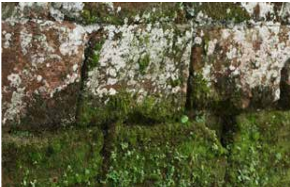
Figura 6: Musgos em paredes de arenito no Sítio Histórico São Miguel Arcanjo.
