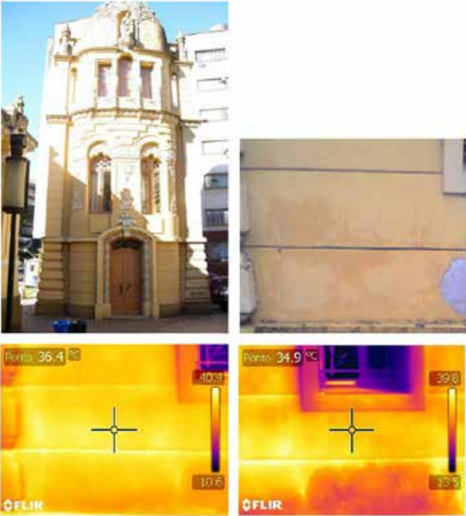
Figura 4 – Observatório astronômico da UFRGS, incidência de descolamento de revestimento e incidência de umidade e imagens térmicas na área não descolada e da área descolada
