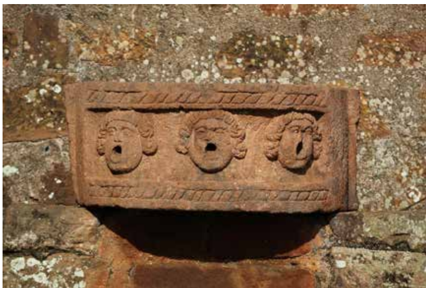
Figura 2: Fonte em arenito após o procedimento de conservação, contrastando com a parede ao fundo, a qual não recebeu tratamento.
