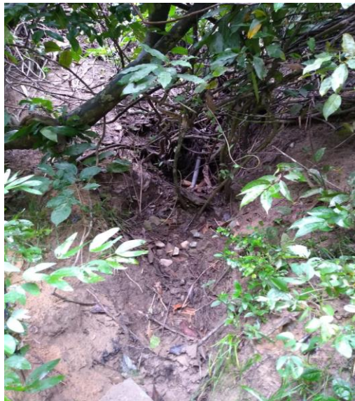
Figura 8 – Processos erosivos identificados
