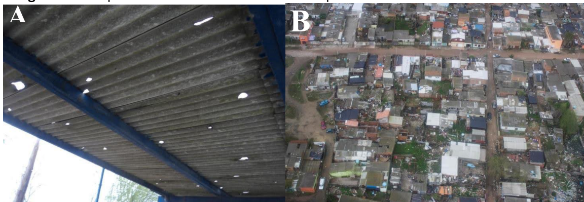
Figura 3: Exemplos dos danos causados no município do Rio Grande em setembro de 2015.
