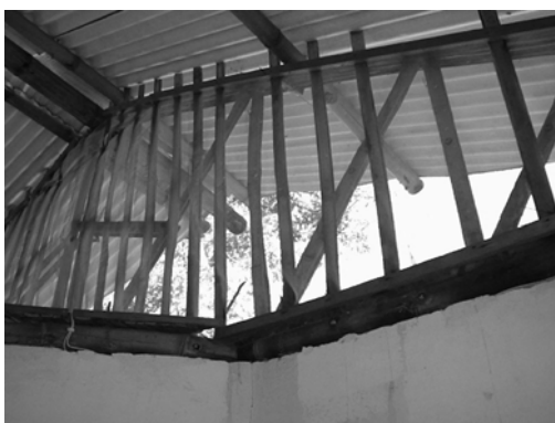
Figura 10 - Vedação insuficiente da treliça
