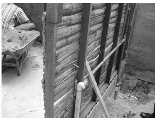
Figura 8 - Tubulação na parte interna do painéis de vedação
