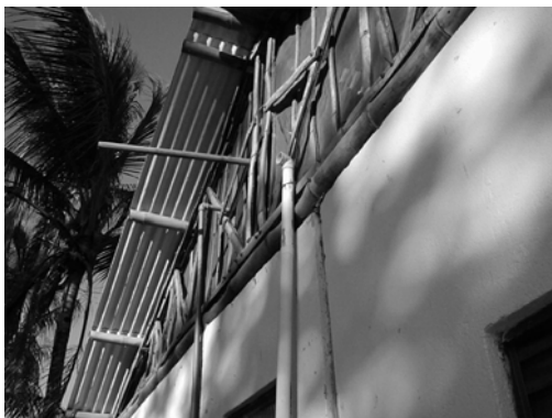
Figura 11 - Tubo de ventilação abaixo da cumeeira
