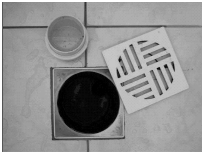
Figura 5 - Coletor de água cinza e caixa sifonada de um banheiro analisado
