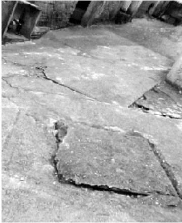
Figura 5 - Tamponamento de caixa de inspeção deteriorado na Favela Parque Amélia, Município de São Paulo
