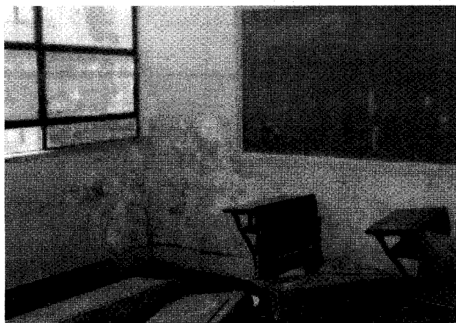
Foto 1 - Umidade e infiltrações de água em sala de aula.
