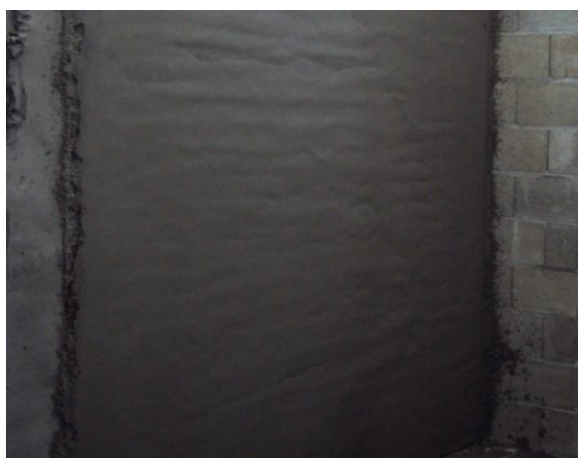
Figura 30 - Ondulação na camada de argamassa - painel 6L
