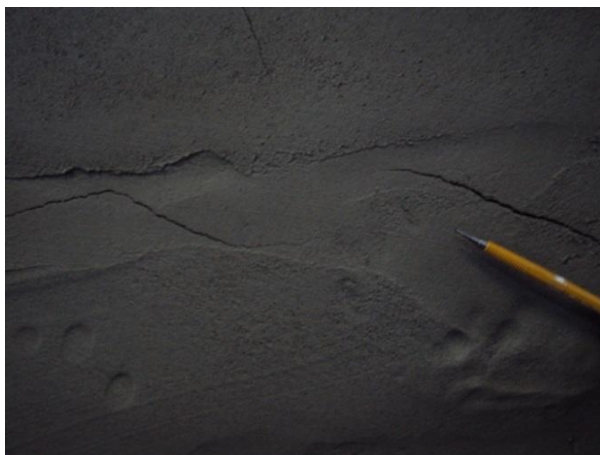
Figura 31 - Fissuras horizontais: escorregamento da camada de argamassa - painel 7L
