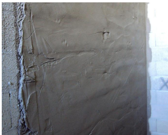
Figura 29 - Escorregamento da camada de argamassa - painel 5L
