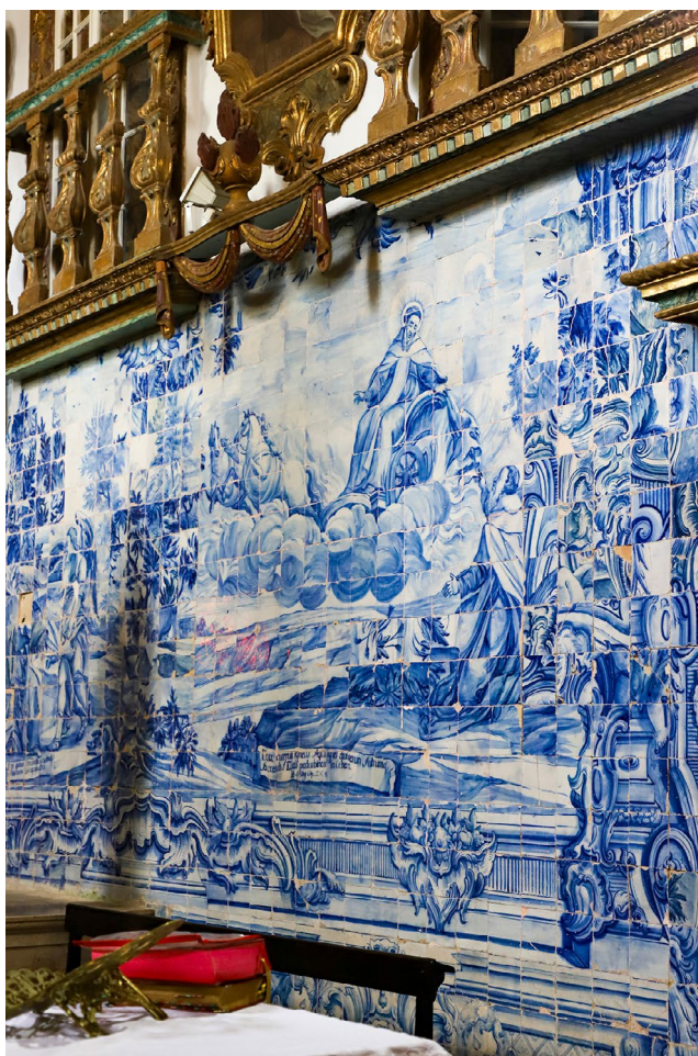
Figura 7. Pannel de azulejos da Igreja da Ordem Terceira do Carmo, Cachoeira, Bahia. Azulejos repostos aleatoriamente na lateral direita do pannel. Fonte: https://upload.wikimedia.org/wikipedia/commons/f/f2/Igreja_da_Ordem_Terceira_do_Carmo_Cachoeira_Chancel_Azulejos_2019-8832.jpg .
