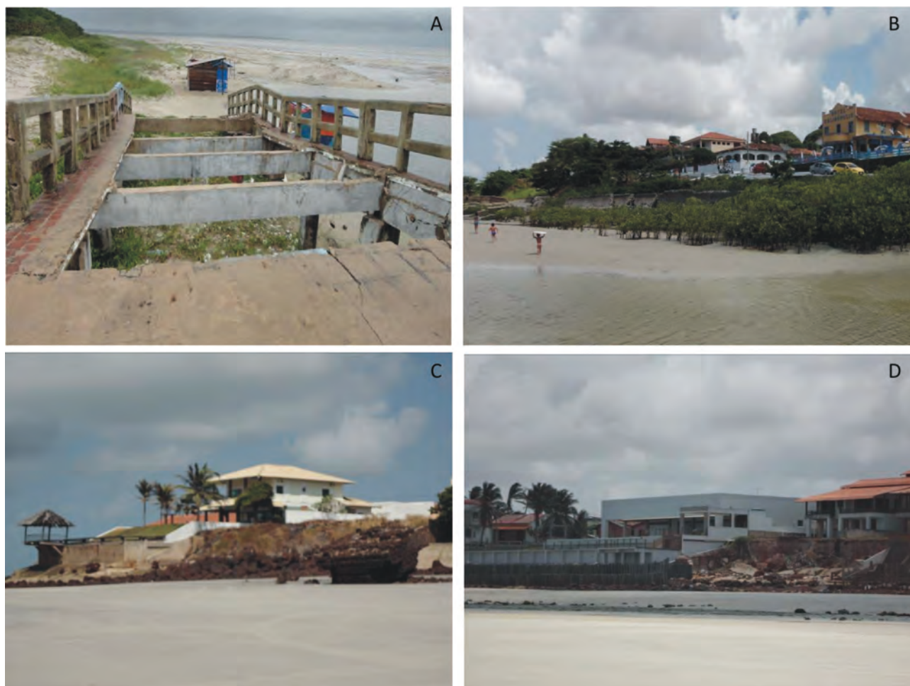
Figura 5. Indícios de erosão nas principais praias de Salinópolis se traduzindo por: A) destruição da ponte que interliga a “Orla do Maçarico” à praia da Corvina. B) desmoronamento gradativo de muros de arrimo na foz do Rio Sampaio, praia do Maçarico (06/10/2013); C) na praia do Farol Velho; D) na praia do Atalaia. Fotografias registradas em 26/04/2013 (A) e 06/10/2013 (A, B e C).
