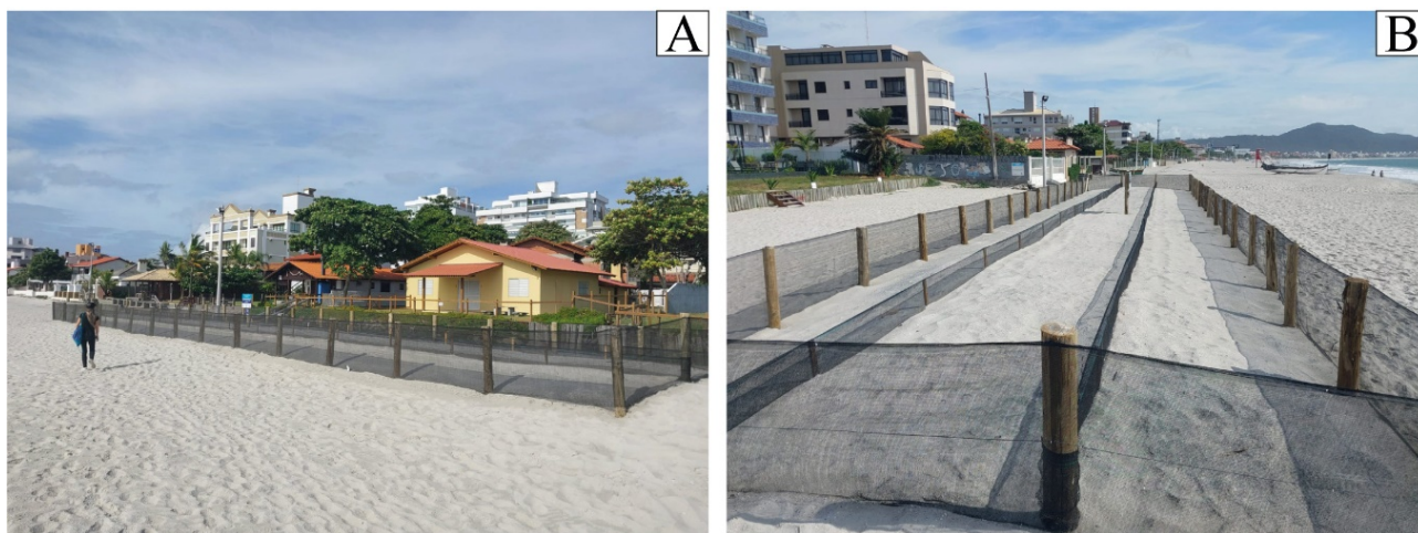
Figura 14. A) Setor da praia dos Ingleses onde deveria ter sido implementado um programa de recuperação das dunas frontais. Ressalta-se que a elevação topográfica foi construída concomitante a obra, no entanto, a plantação de mudas não foi executada. Além disso, apenas uma ação isolada foi realizada, sem a efetiva implementação de um programa de monitoramento. B) Detalhe da área cercada onde originalmente se buscava preservar as características morfológicas do sistema de foredunes . Fotografias do autor.
